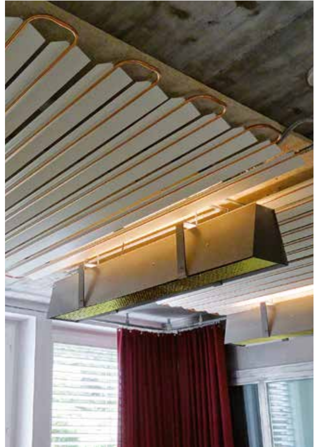
HLM mit sichtbarem Kupferrohr
