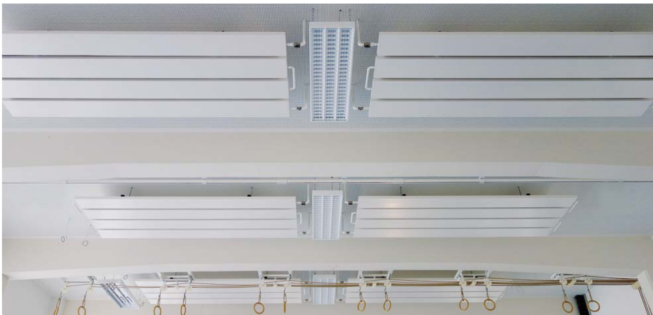
Turnhalle mit DSM-Modulen beheizt
